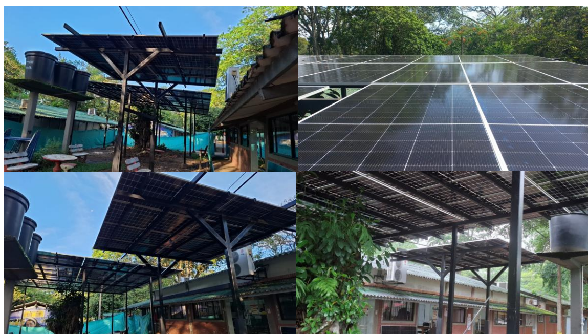
Ilustración 25. Sistema solar fotovoltaico instalado en el Bloque 19.
